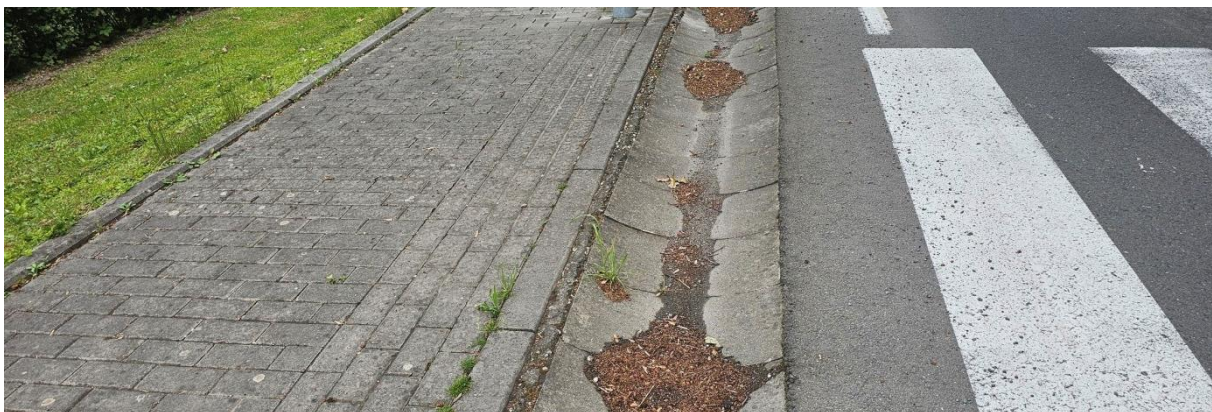
Obr. 12: Odvodňovací žlab jako rizikový prvek bezpečného vstupu na přechod
